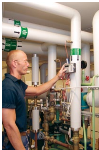
Lämmitysjärjestelmä toimii hallitusti kun putket on asianmukaisesti eristetty.
