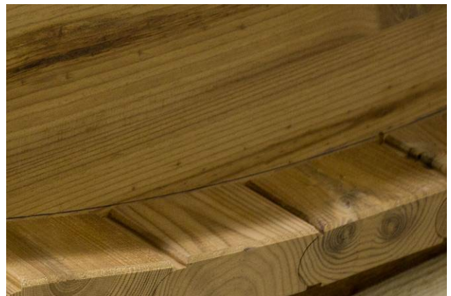
Tässä sivulaudat seuraavat merkiviivaa mutta sivulautojen välissä on rako
